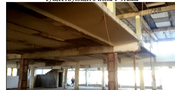
Фото №6. Общий вид конструкций усиленных колонн, существующих ригелей и плит перекрытия 1-этажа здания после частичного демонтажа плит и промежуточной части двух ригелей; демонтаж выполнен для установки лифта на этом участке здания
