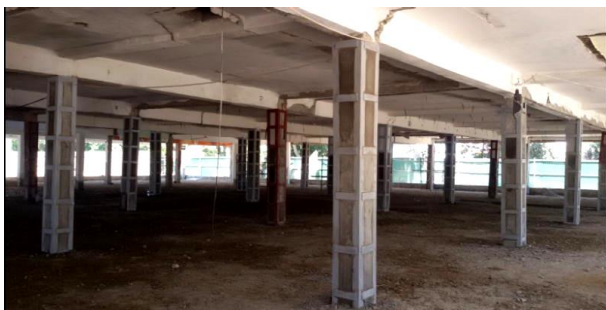
Фото №5. Общий вид конструкций усиленных колонн, существующих ригелей и плит перекрытия 1-этажа здания
